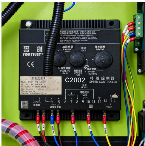
Elektronischer Drehzahlregler im Schaltschrank
